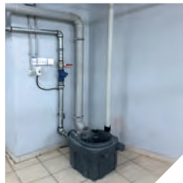
-2. katın zeminine kurulan SANIFOS 110
