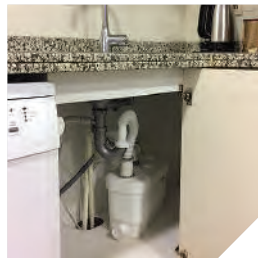
Tezgâhın altına gizlenmiş SANIVITE pompa
