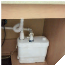
Mutfak eyesinin altına gizlenmiş SANIVITE pompa
