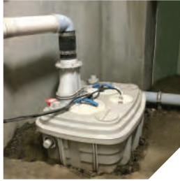
Montajı yapılmış SANICUBIC 2 VX
