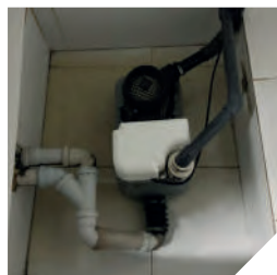
-1. kattaki depoya kurulmuş SANICOM 1
