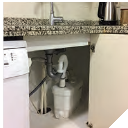
Tezgâhın altına gizlenmiş SANIVITE pompa
