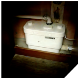
Tezgahın altına gizlenmiş SANIVITE pompa
