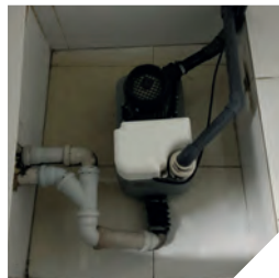
-1. kattaki depoya kurulmuş SANICOM 1
