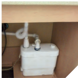
Mutfak eyesinin altına gizlenmiş SANIVITE pompa
